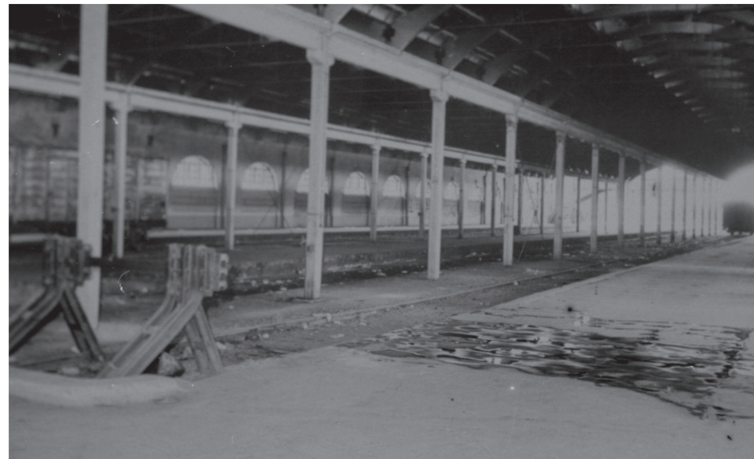
Arriba: corte transversal de la obra en el estado previo a la intervención (1998). | Abajo: F.C.C.A. Estación Rosario Central en 1979. Fuente: Archivo de Fotografía de la Escuela Superior de Museología.
